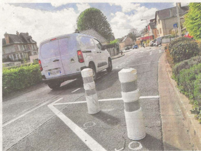
De nouveaux aménagements, avec quatre places de stationnement sur la chaussée, viennent d'être installés rue des Canadiens à Saint-André-sur-Orne pour faire ralentir les automobilistes.
